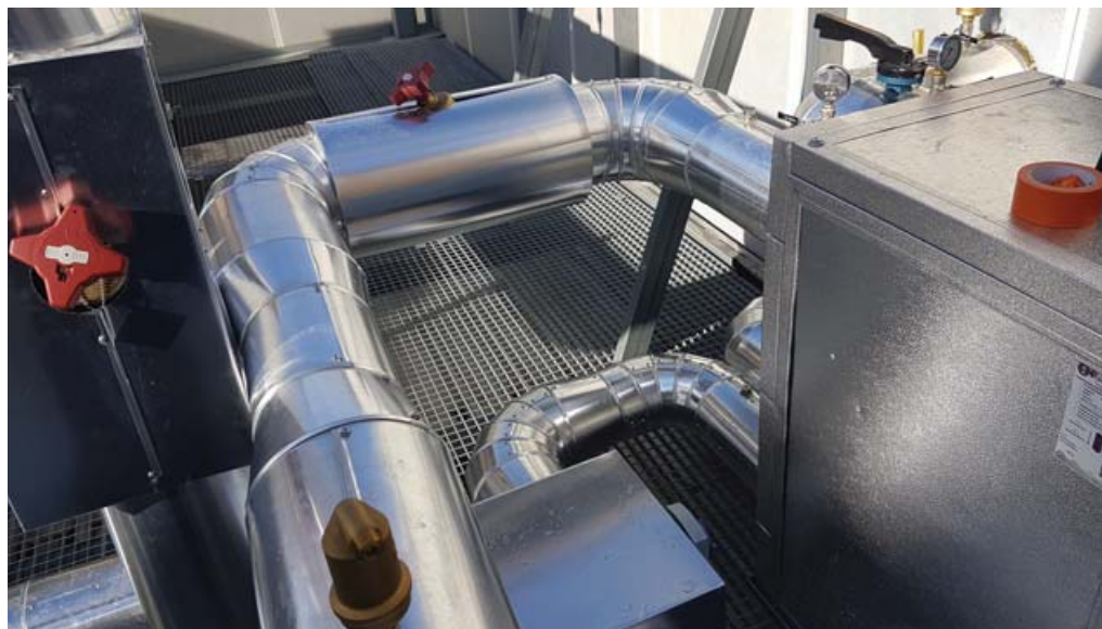
➤ L'échangeur à plaques réchauffe le retour d'eau chaude avant son stockage dans un ballon.
