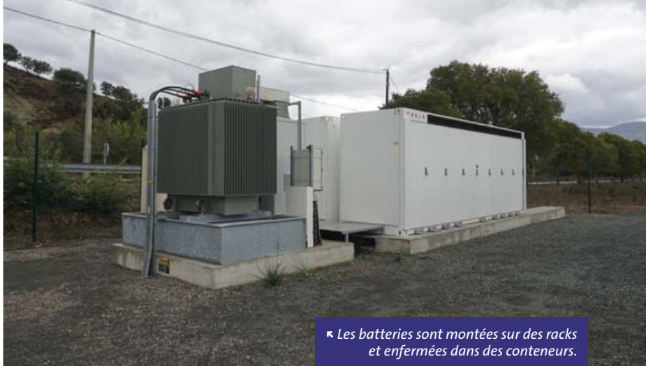
→ Tesla fournit l'ensemble des batteries et assure leur gestion pendant 25 ans.
