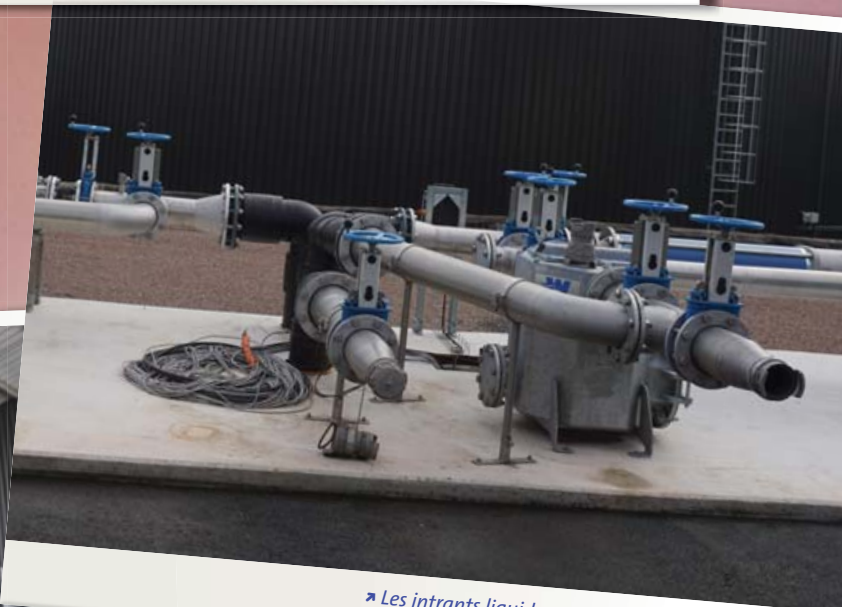
➤ Les intrants liquides sont acheminés dans le digesteur grâce à un système de pompage.
