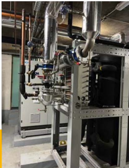
➤ Le nouveau groupe froid de la patinoire dispose d'un système de récupération de la chaleur fatale pour les besoins de la piscine voisine.
