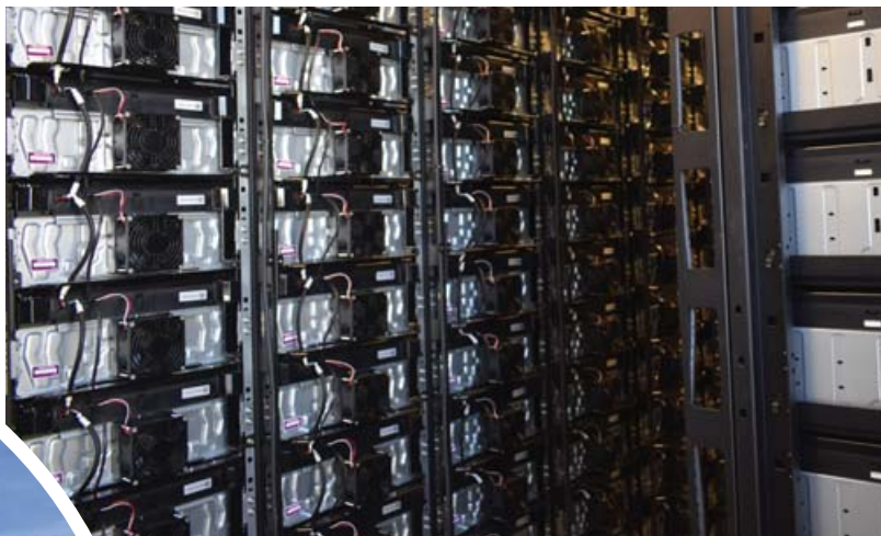
Les conteneurs de stockage sont constitués principalement de baies de batteries lithium-ion.
