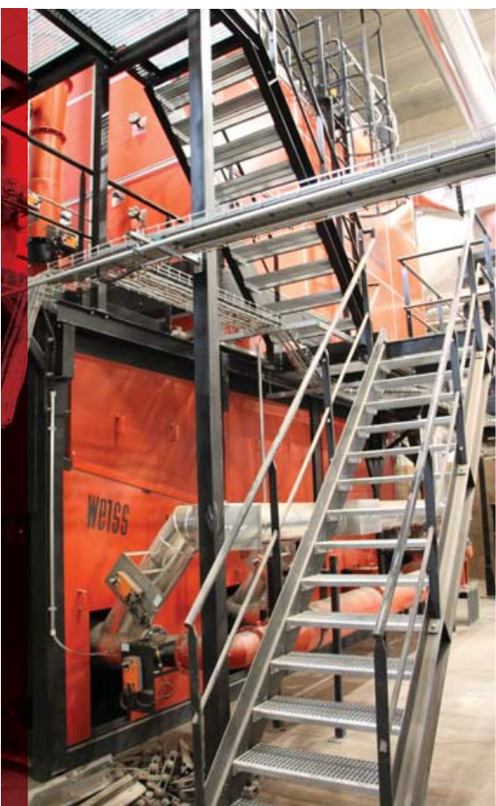
➤ Une chaufferie biomasse de 4,2 MW a été installée. L'intégralité de la production de chaleur a été renouvelée.
