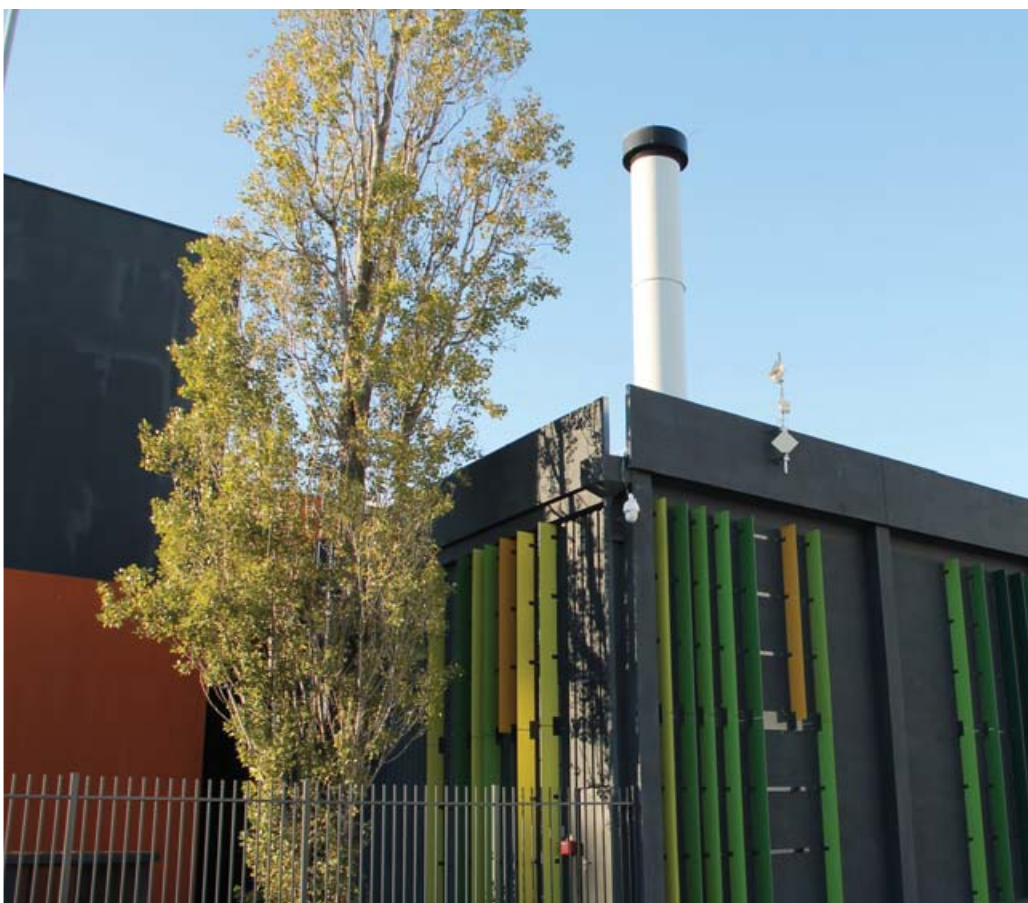
➤ Un système de traitement des fumées a été mis en place.
