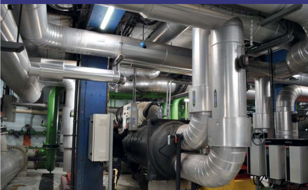
Trois groupes froid répondent aux besoins du complexe immobilier. Chaque machine a une puissance de 4 MW. Douze tours de refroidissement ouvertes traitent leurs rejets ainsi que ceux des groupes électrogènes.
