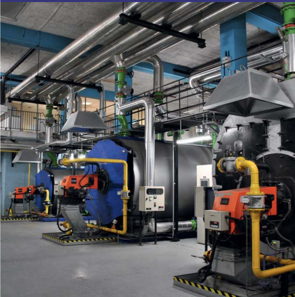
La production de chaud est assurée par 4 chaudières dont les puissances varient : 800 kW (initialement pour les besoins d'eau chaude sanitaire de l'hôtel en été), 3,7 MW pour la mi-saison, 6,2 MW et 6,7 MW.
