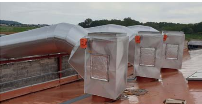
➤ Autrefois évacuées, les 100 000 m 3 de fumées issues du cycle de préchauffage sont désormais captées et renvoyées vers les échangeurs cycloniques.
