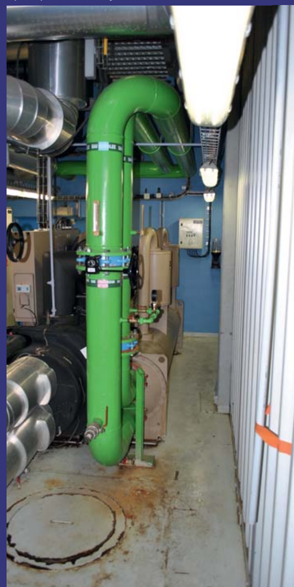
Deux bacs, l'un en béton, l'autre en acier, permettent de stocker en tout 6,3 MW d'eau glacée. Le cycle de stockage-déstockage peut être actionné à tout instant, la glace formée dans l'accumulateur n'a pas besoin d'être complètement fondue pour qu'un nouveau cycle recommence.
