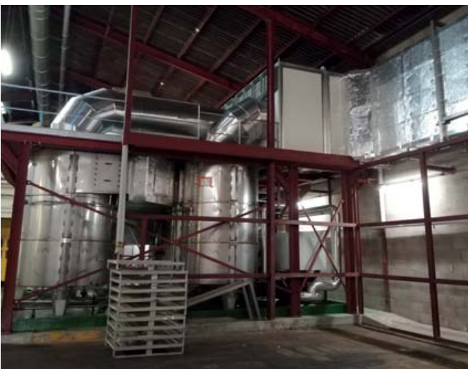
➤ Quatre échangeurs cycloniques assurent la séparation des follicules d'oignons, de l'humidité et de l'air chaud.
